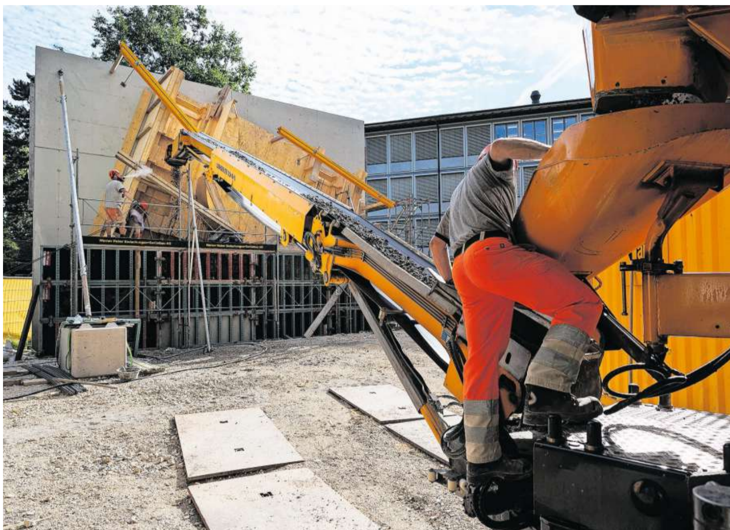
Die Arbeiter am Werk: Für die beiden Berntor-Kopien wird das Betongussverfahren angewandt.
